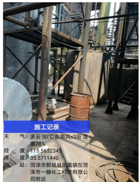
锅炉及废气处理设施
