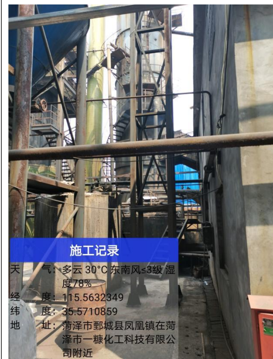
锅炉及废气处理设施
